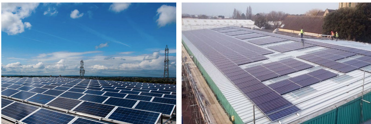
Figura 41 – Pannelli fotovoltaici tradizionali (PV) opachi sul tetto ( www.solarsense.com )
